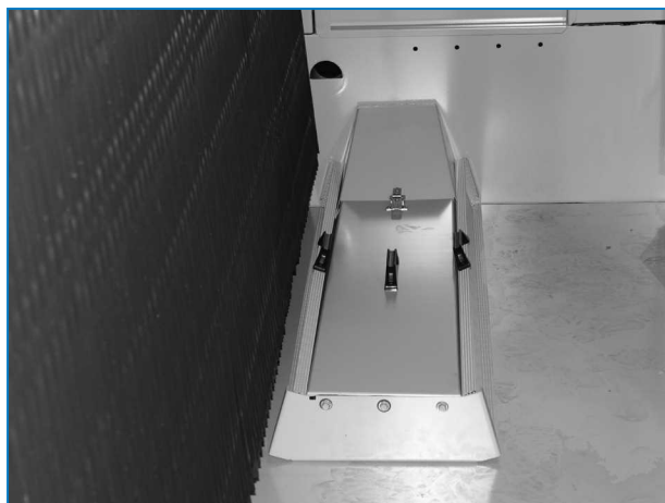
Bassin d'eau froide et tamis
