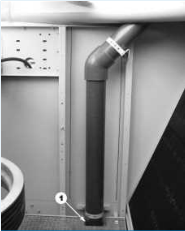
Interior de la sección de plenum de la tubería de la bomba
