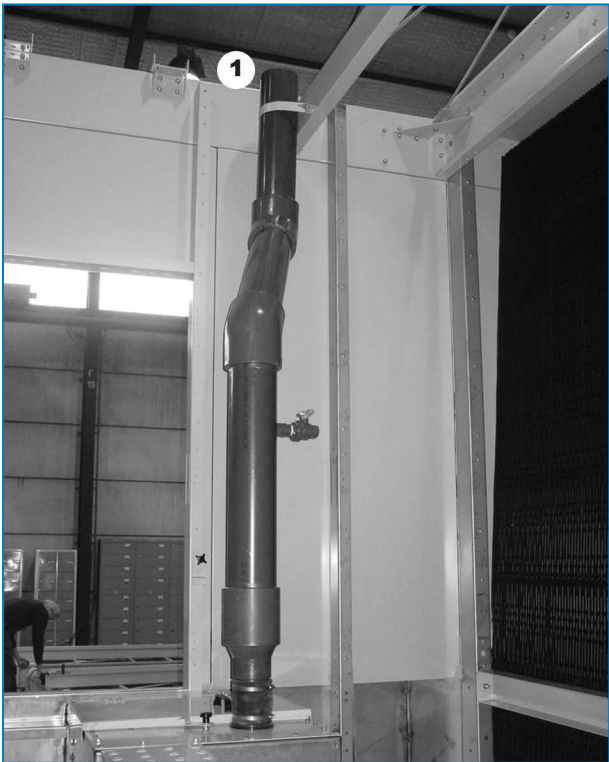
Sección inferior de la tubería de la bomba
