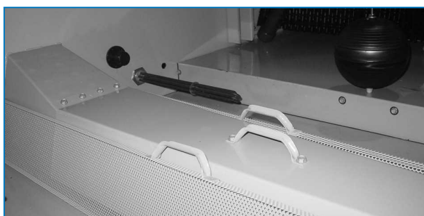
Koudwaterbekken en bekkenfilter
