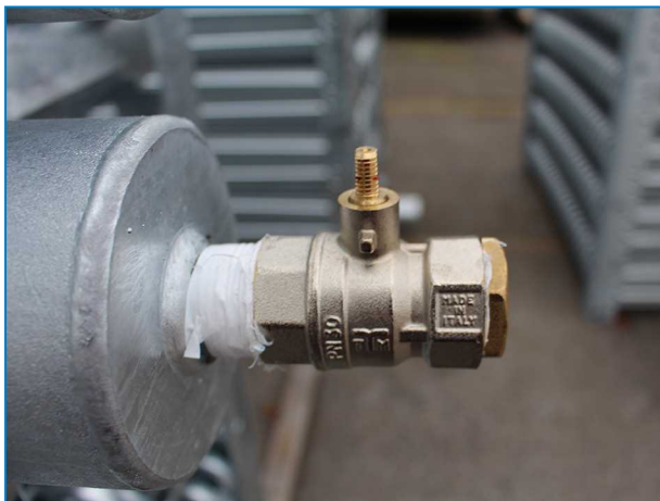
Övre slingkoppling med övertrycksventil på kondensorer.
