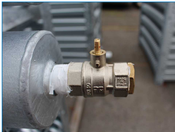
Ligação da serpentina superior com válvula de alívio de pressão nos condensadores.
